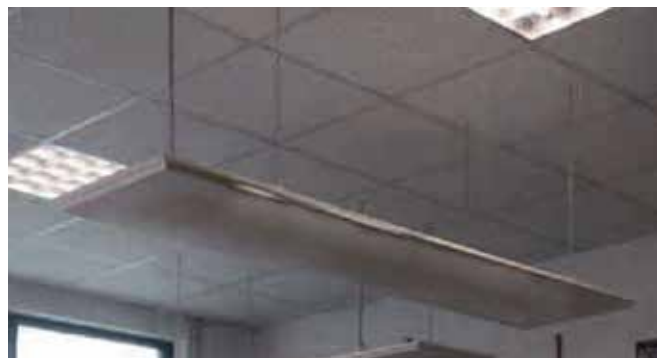
PANOU RADIANT INSTALAT
